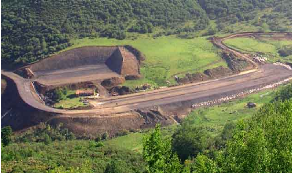
Locura y paranoia en Aller. Futuro parking; viva la destrucción de hayedos!
